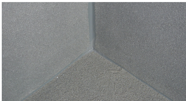
Ingen sanding i bevægelseszoner
