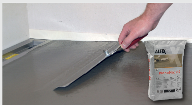
Falloppbygging ved designsluk
