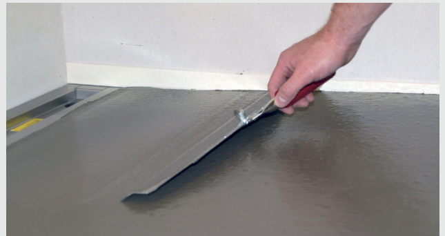
Falloppbygging ved vegg nært sluk
